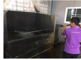
จุดฉีดน้ำล้างจิกฟอสส์
