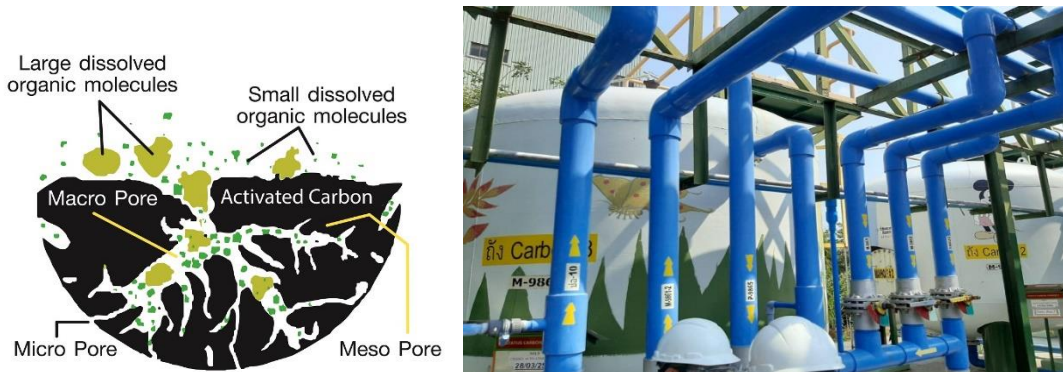
รูปที่ 2.1 ถังกรองคาร์บอน
