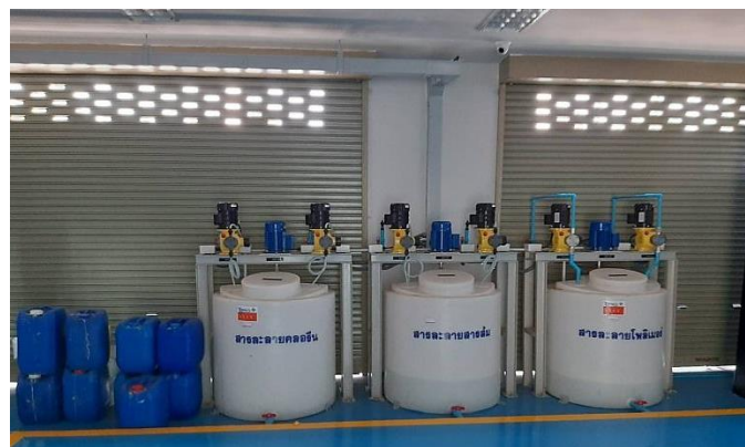
รูปที่ 4.15 ถังเติมสารเคมี
