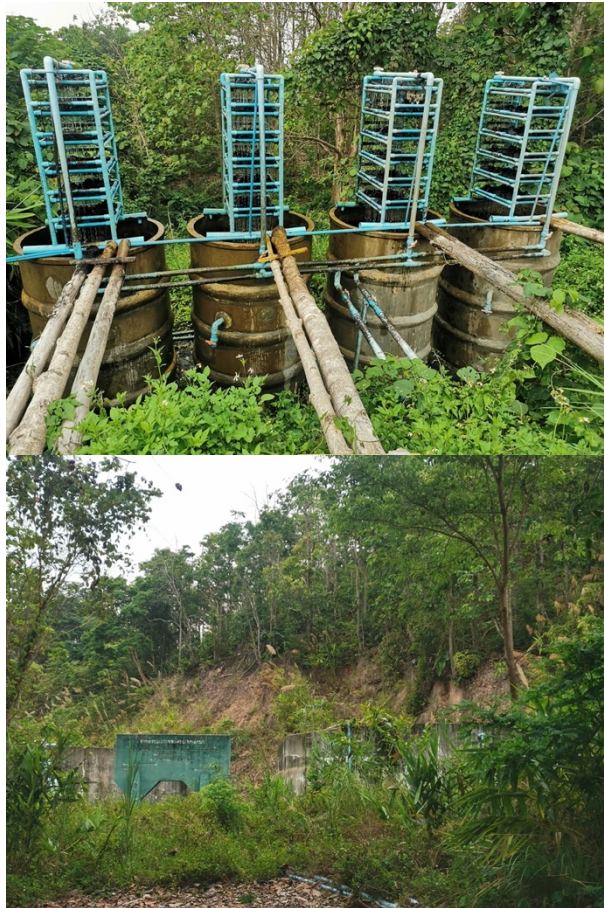
ภาพที่ 3. 38 ระบบกรองน้ำและแท็งค์สำรองน้ำปะปาภูเขาเพื่อจ่ายเข้าครัวเรือน
