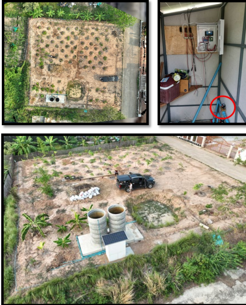
รูปที่ 6-9 รูประบบน้ำและระบบควบคุมที่ติดตั้งที่โครงการสวนผสมผสาน
