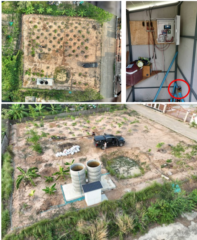
รูปที่ 3-69 รูประบบน้ำและระบบควบคุมที่ติดตั้งที่โครงการสวนผสมผสาน
