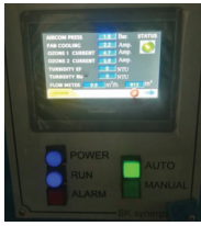
หน้าจอแสดงการทำงานของระบบไอโชน และควบคุมความเข้มข้นของน้ำก่อนนำเข้าสู่ระบบผลิตน้ำรีไซเคิล
