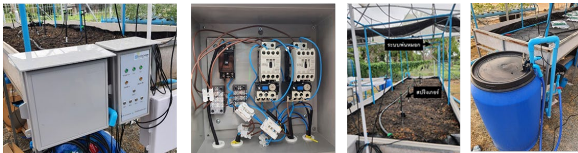
รูปที่ 3-63 ระบบอุปกรณ์ภายในโรงเรือน
