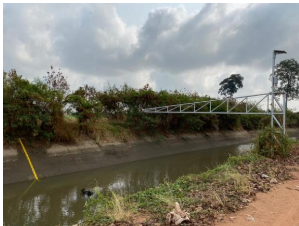
สถานีวัดระดับน้ำที่ 1 คลอง MC กม.4+900 และจุดติดตั้ง Staff gauge
