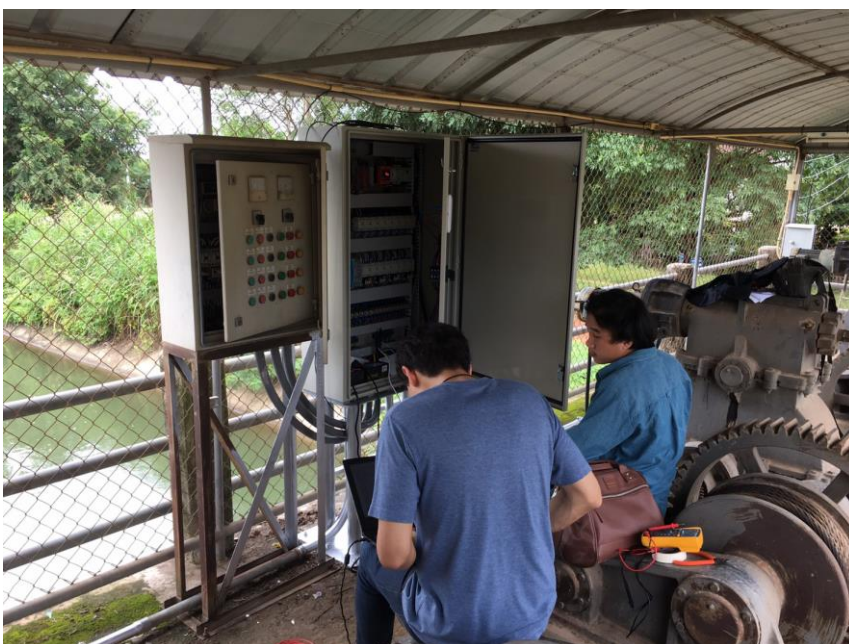
รูปที่ 3-15 ผลการตั้งค่าและแก้ไข Limit Switch และทดสอบการเชื่อมต่อของอุปกรณ์ต่าง ๆ ในตู้คอนโทรล
