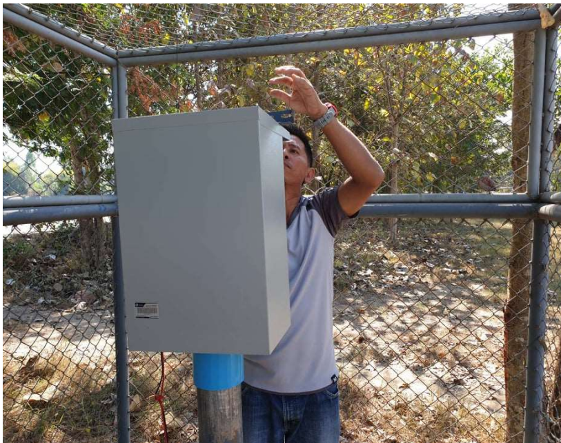
ภาพที่ 1 การทดลองติดตั้งระบบ และอุปกรณ์วัดระดับน้ำบาดาลแบบ Real-Time
