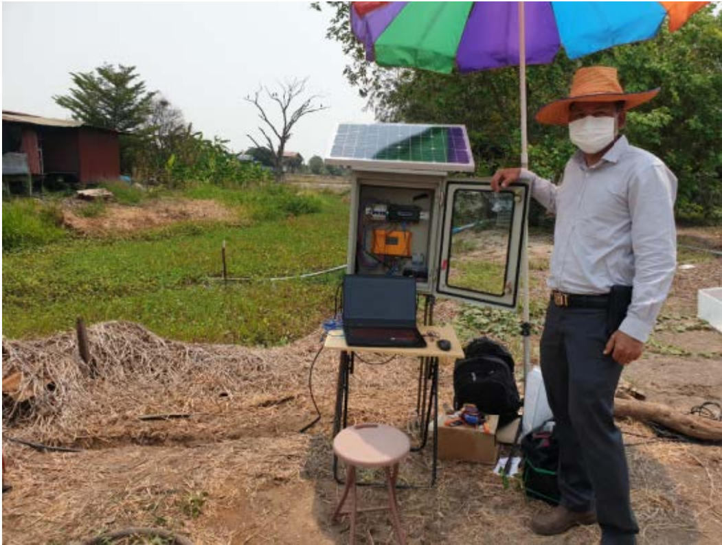
รูปที่ 5.2-22 สถานีวัดที่ 4 ฐานรองรับชุดเครื่องมือกับบ่อน้ำต้นสังเกตการณ์ และติดตั้งตู้ควบคุมบนบ่อพร้อมประกอบอุปกรณ์ระบบเซนเซอร์ ชุดควบคุม ชุดแหล่งจ่ายไฟฟ้าสำหรับจ่ายพลังงานให้กับชุดเซนเซอร์ และชุดแผงโซลาเซลล์
