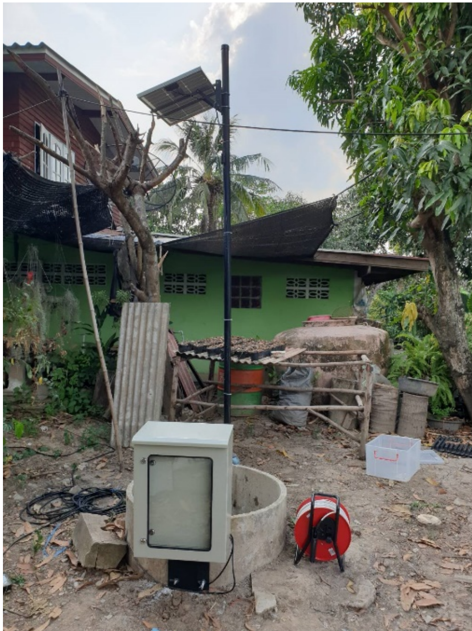
รูปที่ 5.2-18 สถานีวัดที่ 2 ฐานรองรับชุดเครื่องมือกับบ่อน้ำต้นสังกัดการณ์ และติดตั้งตู้ควบคุมบนบ่อพร้อมประกอบอุปกรณ์ระบบเซนเซอร์ ชุดควบคุม ชุดแหล่งจ่ายไฟฟ้าสำหรับจ่ายพลังงานให้กับชุดเซนเซอร์ และชุดแผงโซลาเซลล์บนเสาเหล็กกล้าวาไนซ์
