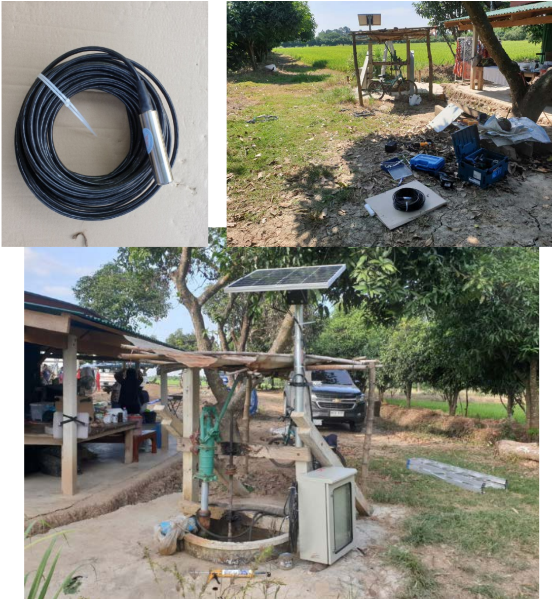
รูปที่ 5.2-16 สถานีวัดที่ 1 ฐานรองรับชุดเครื่องมือกับบ่อน้ำต้นสังกัดการณ และติดตั้งตู้ควบคุมบ่นบ่อพร้อมประกอบอุปกรณ์ระบบเซนเซอร์ ชุดควบคุม ชุดแหล่งจ่ายไฟฟ้าสำหรับจ่ายพลังงานให้กับชุดเซนเซอร์ และชุดแผงโซลาเซลล์บนเสาเหล็กกล้าวไนซ์
