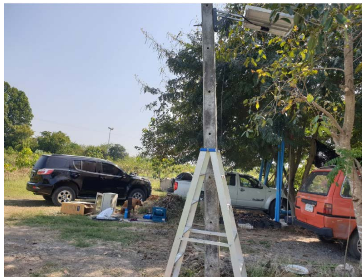
รูปที่ 5.2-20 สถานีวัดที่ 3 ฐานรองรับชุดเครื่องมือกับบ่อน้ำต้นสังกัดการณ์ และติดตั้งตู้ควบคุมบ่อน้ำพร้อมประกอบอุปกรณ์ระบบเซนเซอร์ ชุดควบคุม ชุดแหล่งจ่ายไฟฟ้าสำหรับจ่ายพลังงานให้กับชุดเซนเซอร์ และชุดแผงโซลาเซลล์
