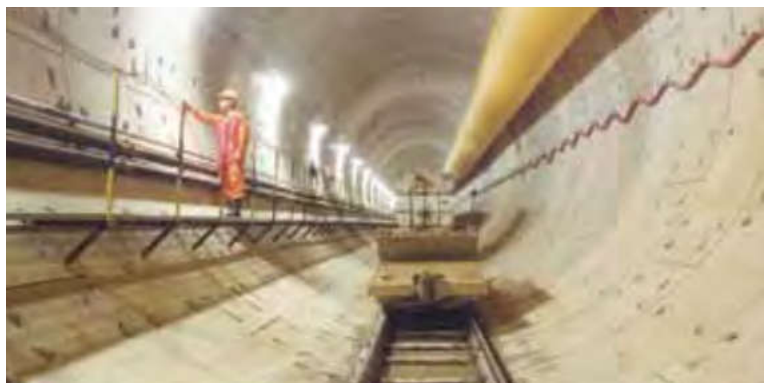
ภาพที่ 4-8 ระบบระบายน้ำทิ้งแบบอุโมงค์ลึก (Deep Tunnel Sewerage System) (International Enterprise Singapore, 2020)
