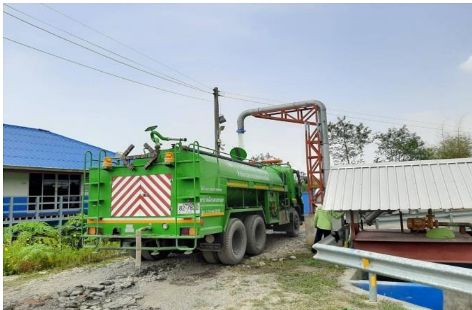
รูปที่ 2.79 ท่อสูบน้ำ Reuse จากบ่อดักตะกอน
