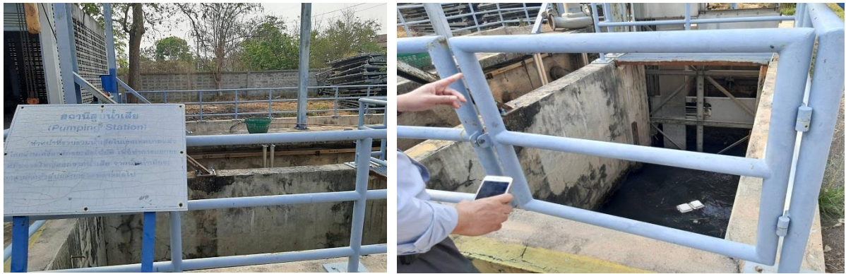
รูปที่ 2.52 สถานีสูบน้ำเสีย
