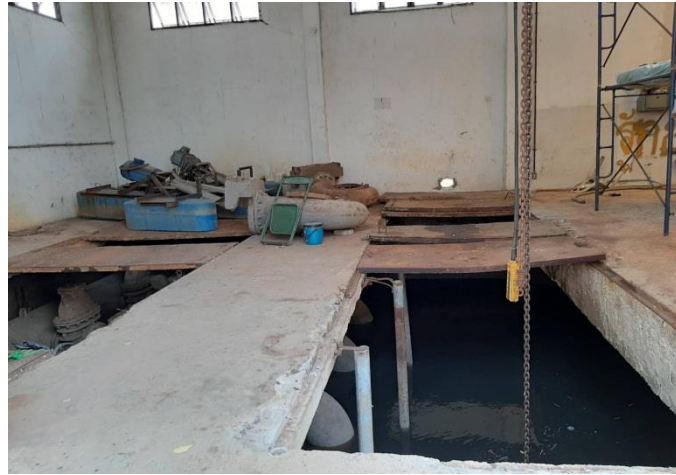
รูปที่ 2.8 บ่อพักน้ำเสีย
