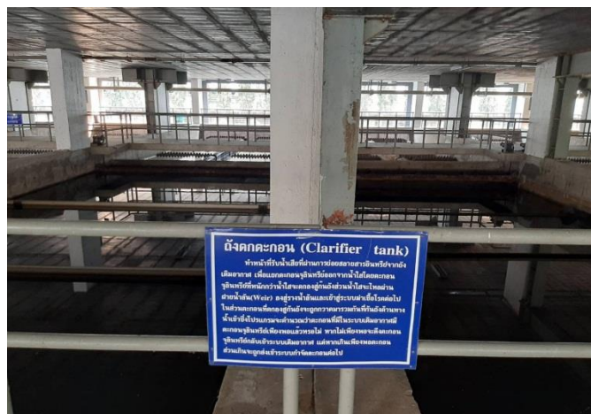
รูปที่ 2.25 ถังตกตะกอน
