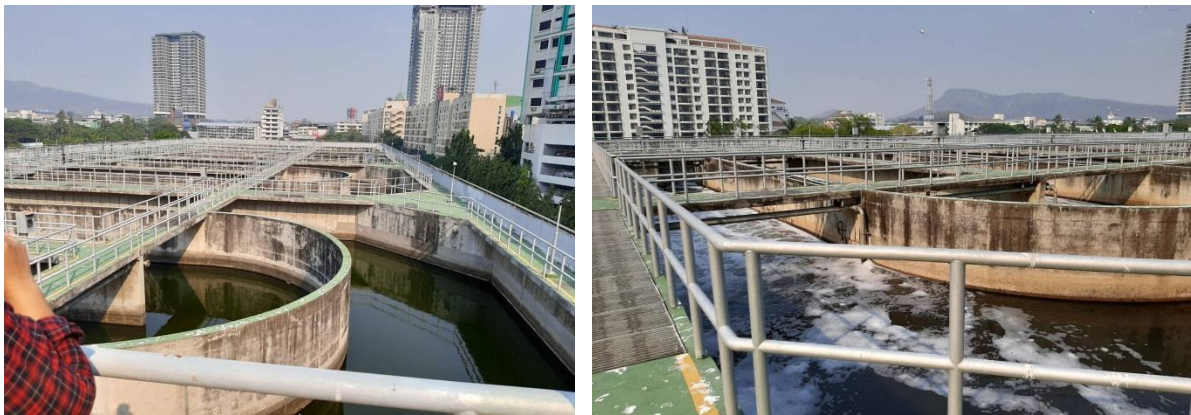
รูปที่ 2.27 บ่อเติมอากาศแบบคลองวนเวียน
