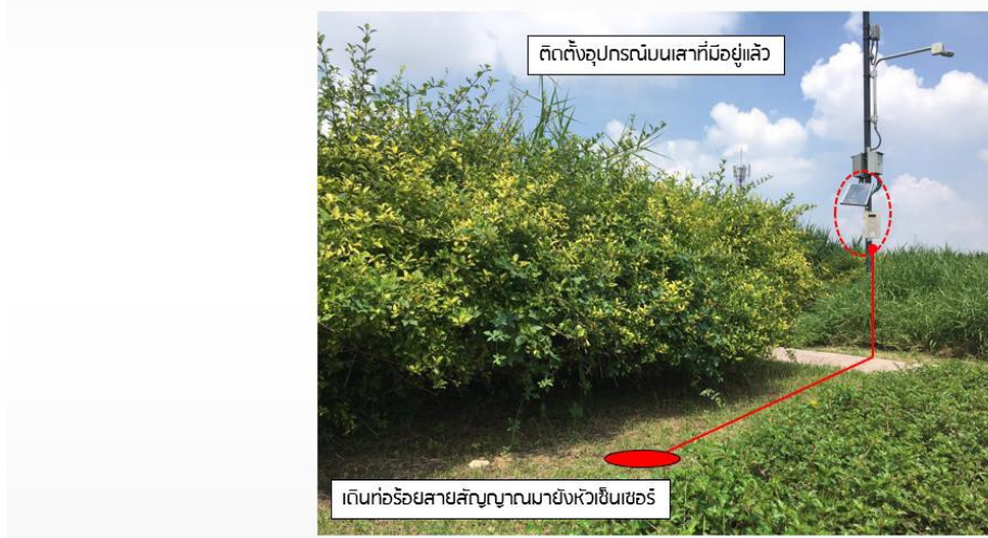
รูปที่ 4.1-5 แสดงจุดติดตั้งอุปกรณ์ตรวจจับ สถานีที่ 3 บริเวณสวนลอย สวน 100 ปีฯ
