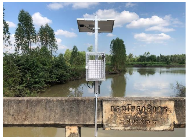
คลอง 1L-MC สะพานห้วยน้ำใส ต.วังตะแบก อ.พรานกระต่าย พิกัด 16.697167 99.674472
