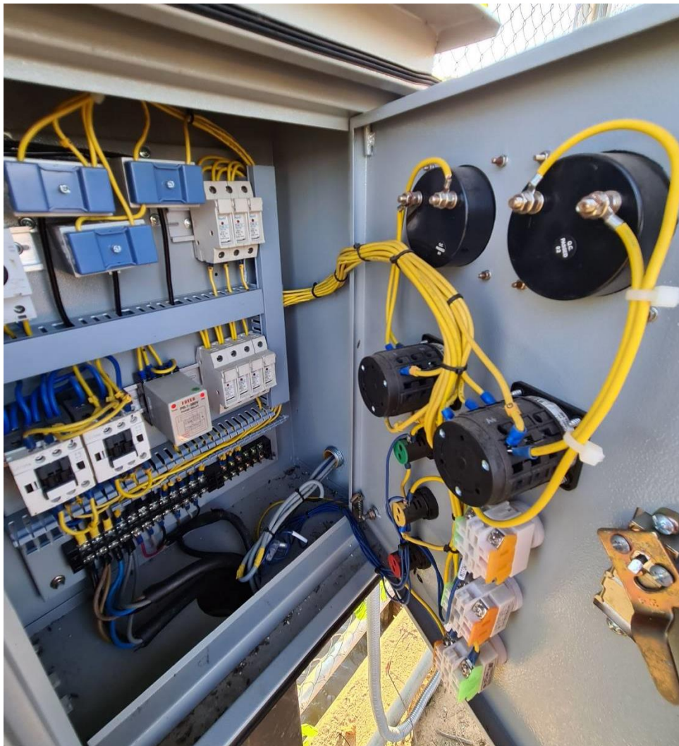
รูปที่ ค-6 ภายในของตู้ควบคุมไฟฟ้าของระบบบริหารจัดการน้ำแบบอัตโนมัติ
