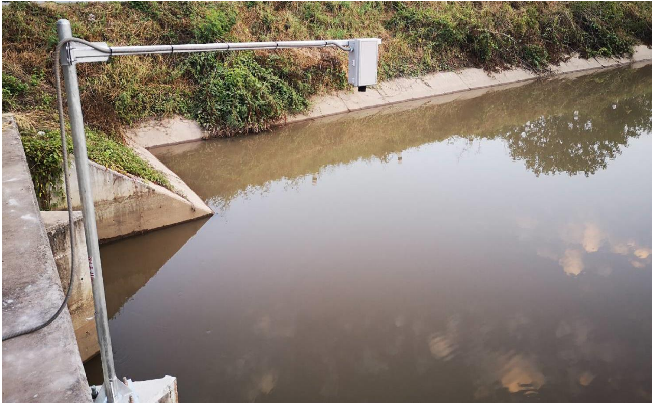
รูปที่ ค-4 เสาติดตั้งเซ็นเซอร์วัดระดับน้ำ
