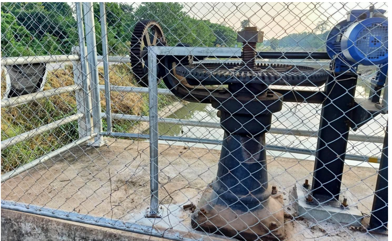
รูปที่ ค-3 ระบบเพลลาซ์ของเครื่องยกประตูระบายน้ำ
