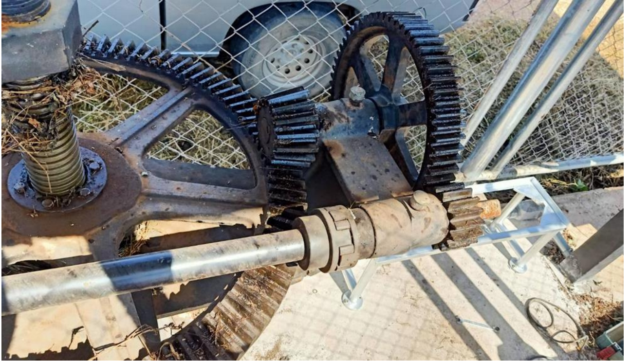
รูปที่ ค-2 ระบบเพลลาซ์ของเครื่องยกประตูระบายน้ำ
