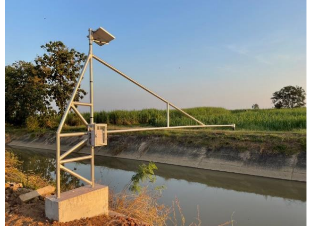
คลอง 1R-1R-2L-MC (จันทิมา-บึงช้าง) ต.จันทิมา อ.ลานกระบือ พิกัด 16.57229 99.75603
