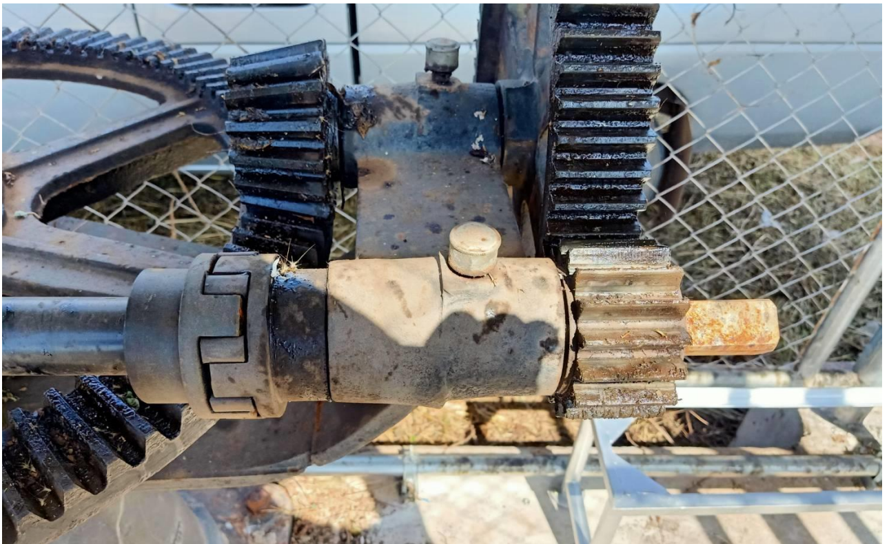
รูปที่ ค-1 ระบบเพลลาขับของเครื่องยกประตูระบายน้ำ
