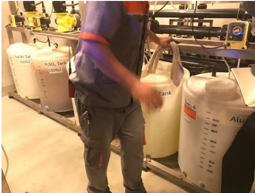
รูปที่ 4-60 แสดงถังเคมีสำหรับบำบัด water reuse
