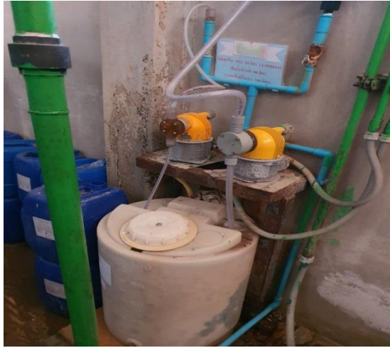
รูปที่ 4-53 แสดงถังและปั๊มคลอรีนในส่วนระบบ Water Reuse
