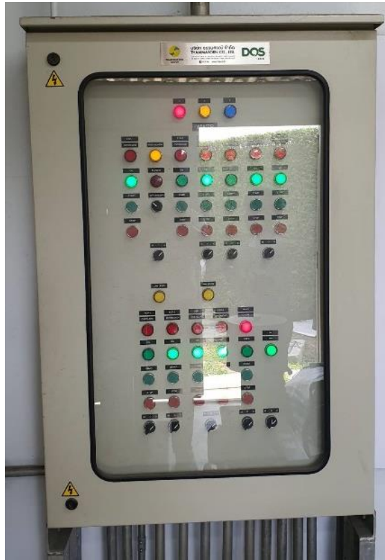
รูปที่ 4-44 แสดงตู้ควบคุมการทำงานของระบบบำบัดน้ำเสียและระบบ Water Reuse
