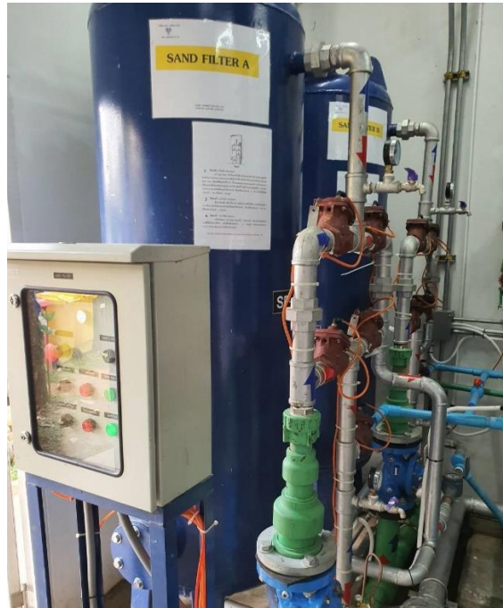
รูปที่ 4-28 แสดงตั้งกรองทรายในระบบ Water Reuse
