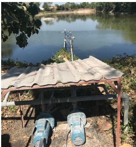
รูปที่ 4-67 แสดงปั้มน้ำที่ทำหน้าที่สูบน้ำผิวดิน
