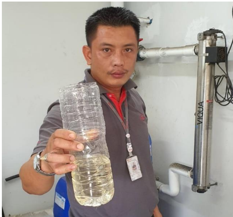
รูปที่ 4-47 แสดงสีอมเหลืองของน้ำที่ออกจากระบบ Water Reuse
