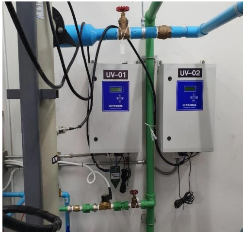
รูปที่ 4-30 แสดงตู้ควบคุมการทำงานของระบบ UV ในระบบ Water Reuse
