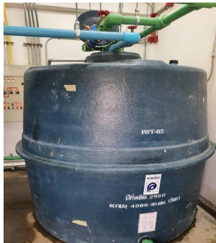
รูปที่ 4-31 แสดงถังเก็บน้ำหลังจากผ่านระบบ Water Reuse
