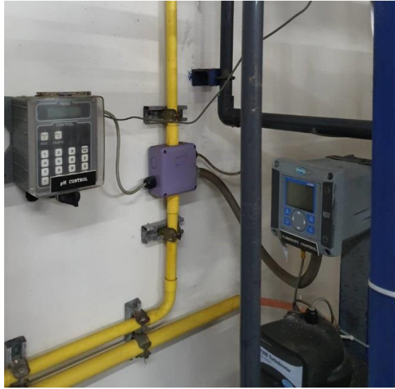
รูปที่ 4-38 แสดงเครื่องควบคุมค่า pH
