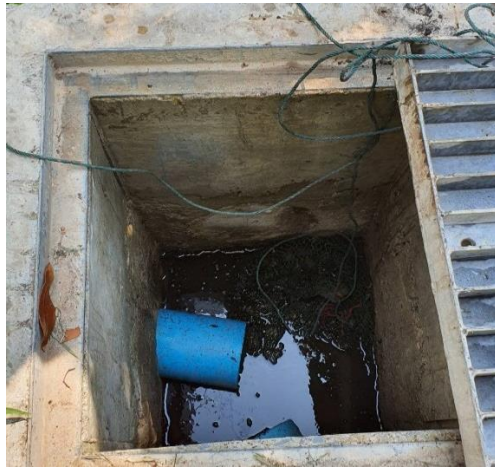
รูปที่ 4-41 แสดง Septic Tank
