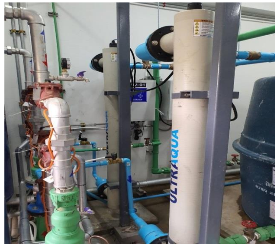
รูปที่ 4-29 แสดงระบบ UV ในระบบ Water Reuse
