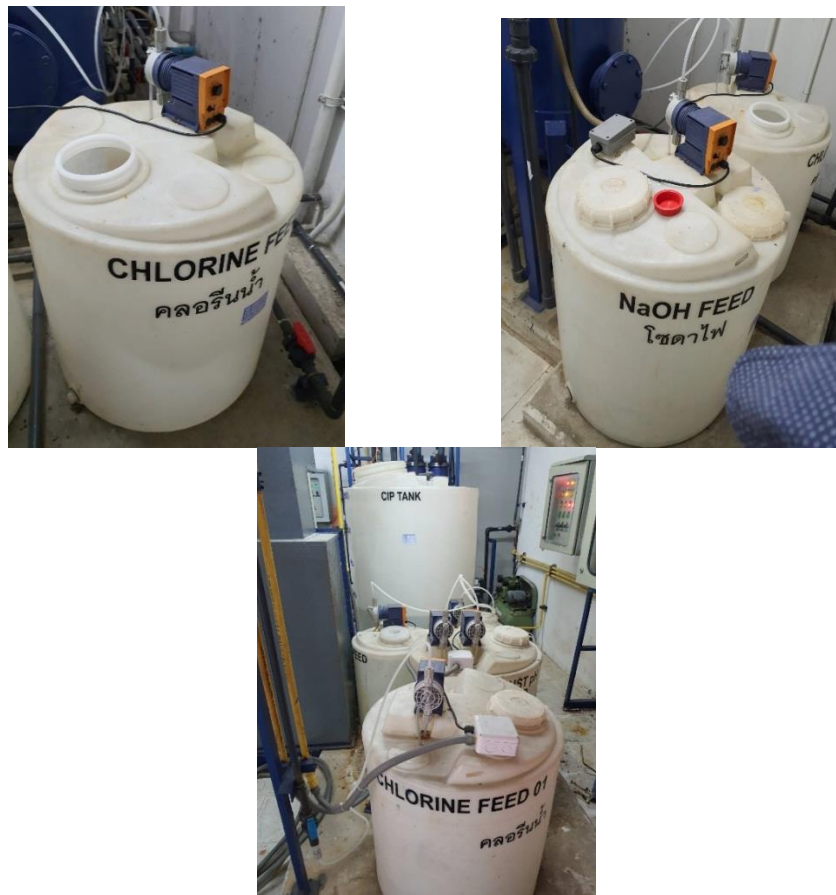
รูปที่ 4-35 แสดงถังเคมีสำหรับระบบ Water Reuse
