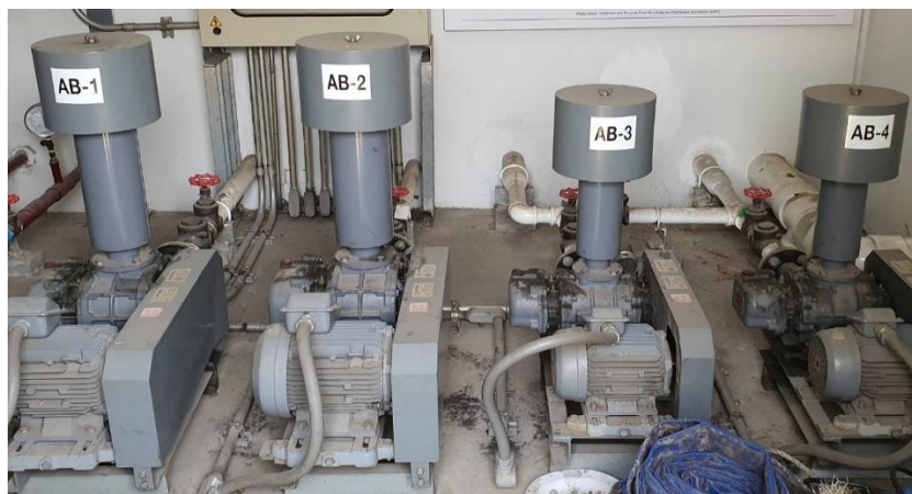
รูปที่ 4-43 แสดงเครื่องเติมอากาศในบ่อ EQ และบ่อเติมอากาศ
