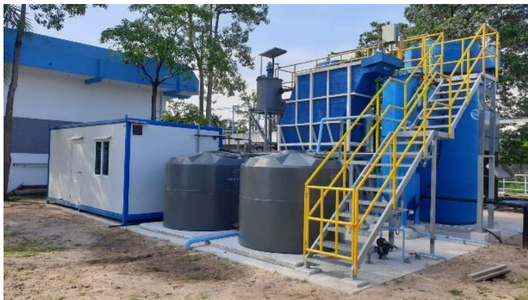
ภาพที่ 3.2.1-1 ระบบบำบัดน้ำเสียแบบ MBBR ณ โรงปรับปรุงคุณภาพน้ำแสนสุข (เหนือ)
