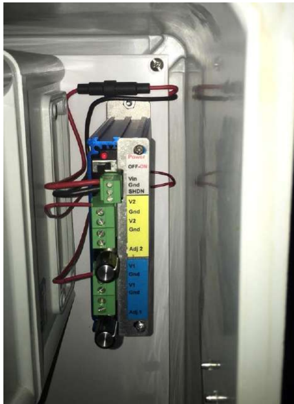
รูปที่ 3-10 Voltages checking at regulator และ Data Logger
