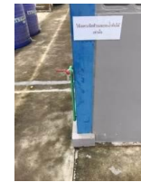
จุดจ่าย น้ำรดต้นไม้
