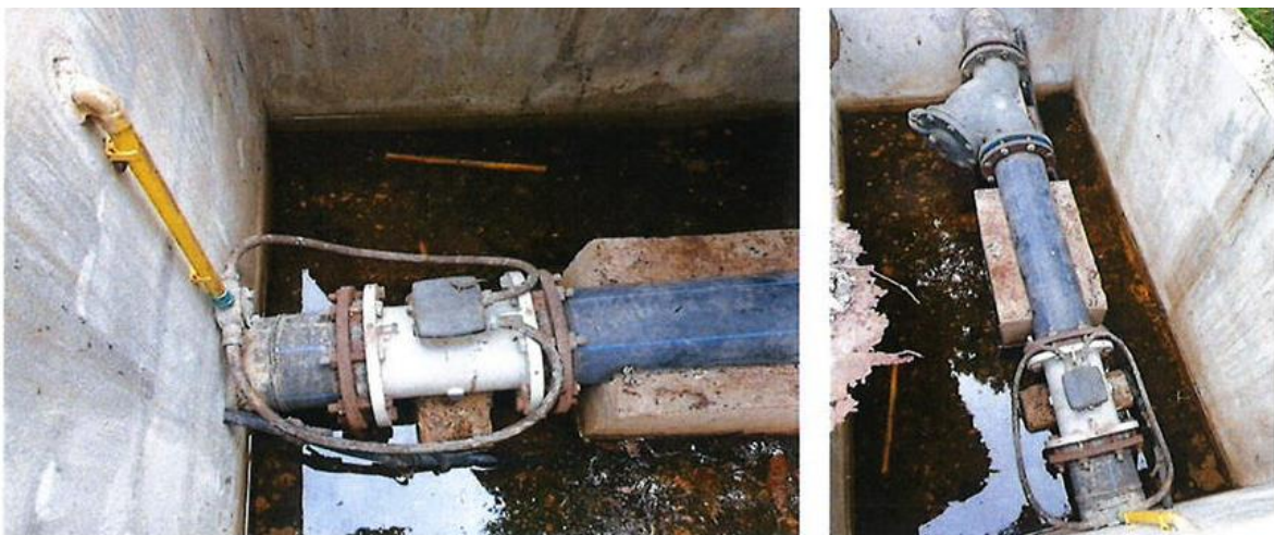
รูปที่ 3-15 ตำแหน่งในการติดตั้ง Electromagnetic flow meter ของสวนอุตสาหกรรมเครือสหพัฒน์ศรีราชา จังหวัดชลบุรี
