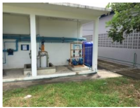
จุดปล่อยน้ำทิ้งหลังบำบัด
