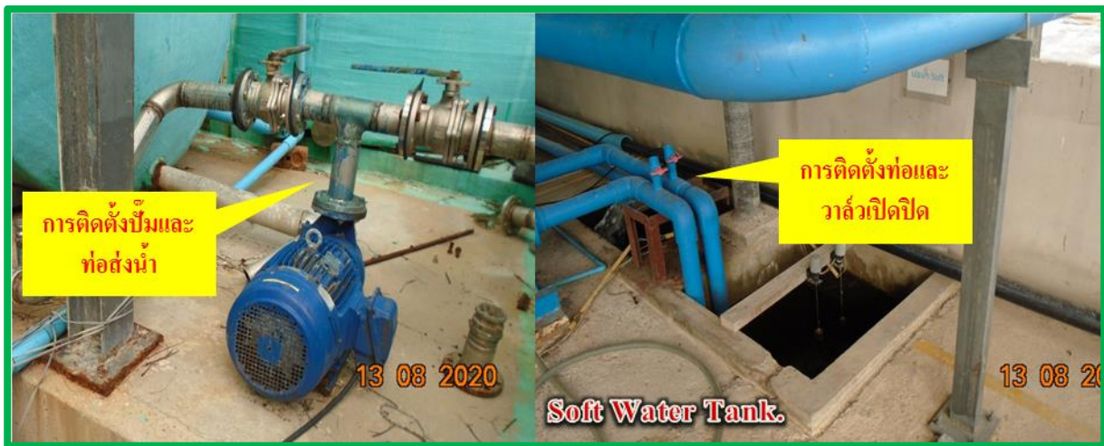
รูปที่ 3-72 เส้นทางเดินท่อเพื่อนำน้ำ Condensate ลงถังบ่อน้ำ Soft ของบริษัท โมเดอร์น ไดस्टัฟส์ แอนด์ พิคเมนท์ส จำกัด
