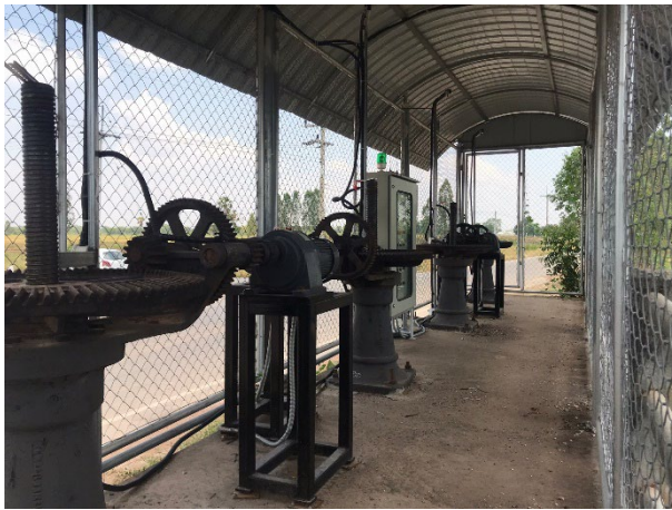
รูปที่ 3 ระบบควบคุมปริมาณการระบายผ่านอาคารบังคับน้ำ
